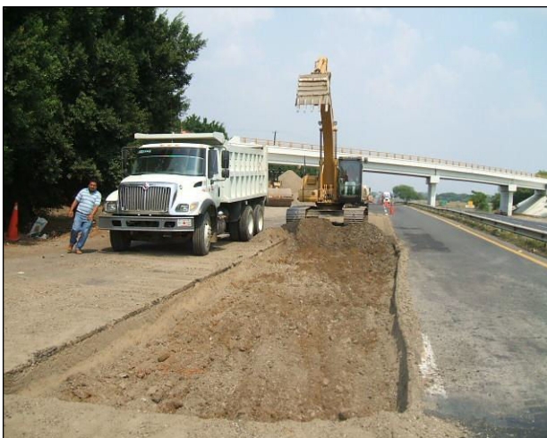
Fotografía 3.- Retiro de material de desperdicio producto de la excavación de la caja del bacheo profundo.
