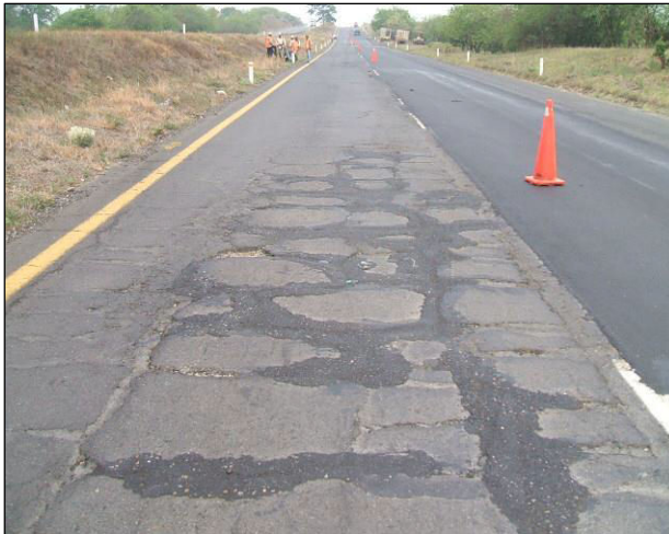
Fotografía 1.- Pavimento asfáltico severamente dañado con agrietamientos y deformaciones.
