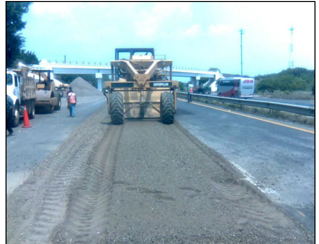
Fotografía 2.- Corte de la carpeta asfáltica existente y base hidráulica ambas con deformaciones.
