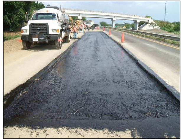
Fotografía 10.- Capa de base después del riego de liga lista para recibir la carpeta asfáltica.
