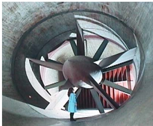
Figura 2: Soplante del túnel de viento mayor.
