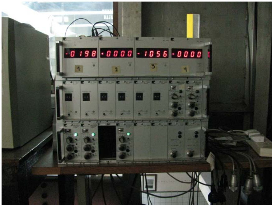
Figura 5: Equipos acondicionadores de señal marca HBM, ubicados en la antecámara del túnel mayor.
