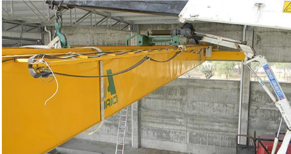
Figura 3: Puento grúa ( Fuente: Firma AAICI )
