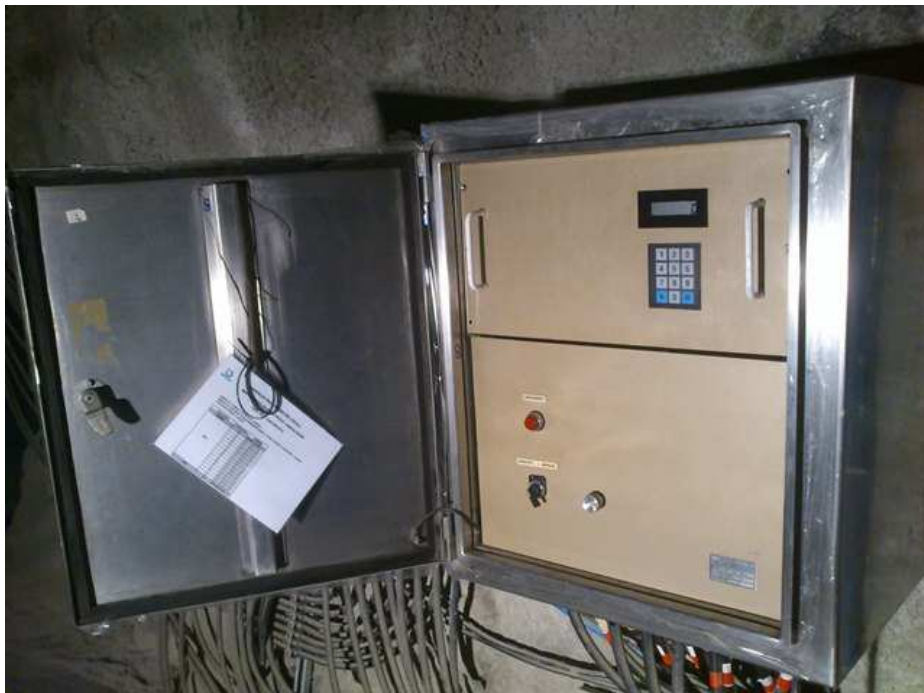
Figura N° 17 Tablero Analizador del GP1 TA-PA03
