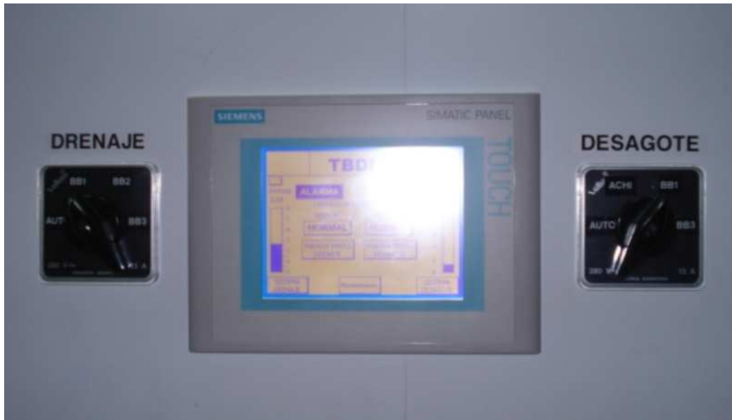
Figura N° 39 Panel táctil sistema de Drenaje y Desagote de central
